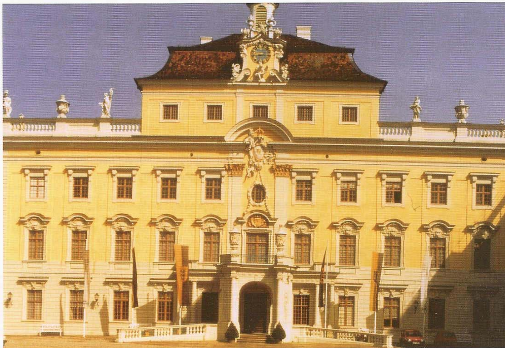
Ein Teil der mit dem Restaurierungsmörtel sanierten Fassade wurde bereits abgerüstet und strahlt jetzt wieder in historischer Zweifarbigkeit in Grau und Gelb.
